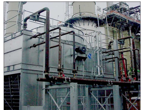
Construcción en acero inoxidable
