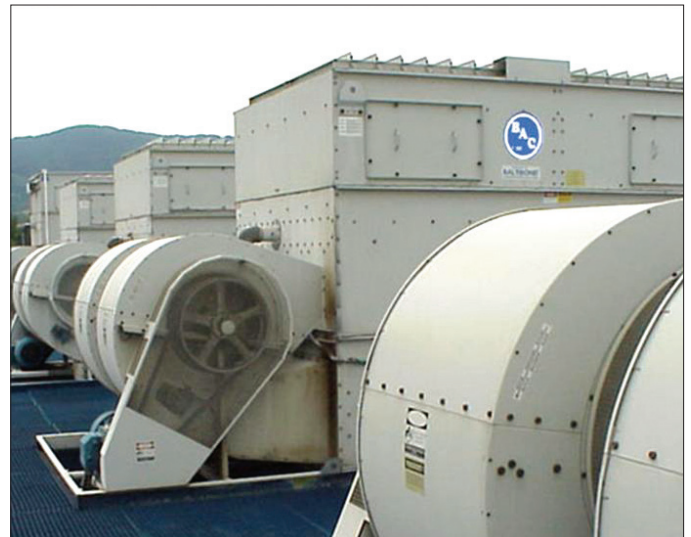
Instalación de VFL multi-celda
